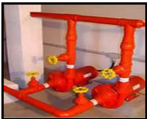
Figura 14 - Bomba de Incêndio
