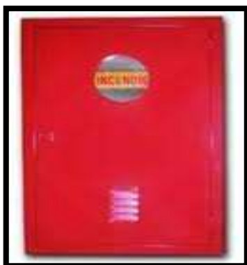
Figura 12 – Hidrante de Parede
